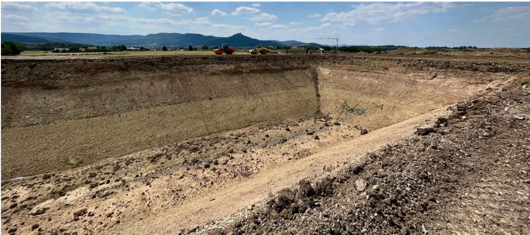
In dieser Riesengrube beim künftigen Wohngebiet Killberg IV wird einst das Wasser gespeichert, das während der Sommer durch Solarenergie aufgeheizt wird und den Winter über für etwa 2000 Einwohner Heizwärme liefern soll. Foto: SB/Klaus Stopper
