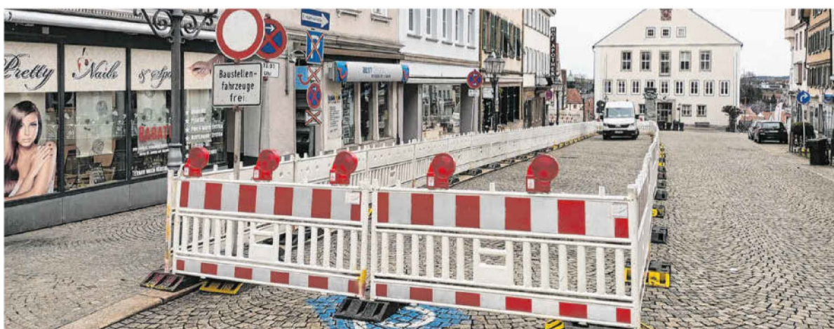
Wo bislang Parkplätze waren auf dem Marktplatz, ist nun eine Baustraße abgesperrt. Foto: Hardy Kromer
