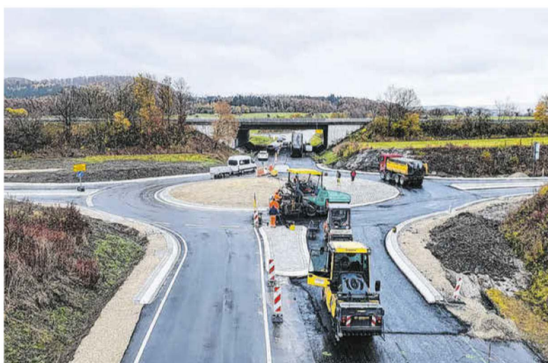
Der neue Kreisverkehr aus der Vogelperspektive (hier noch während die Baumaschinen brummen).
